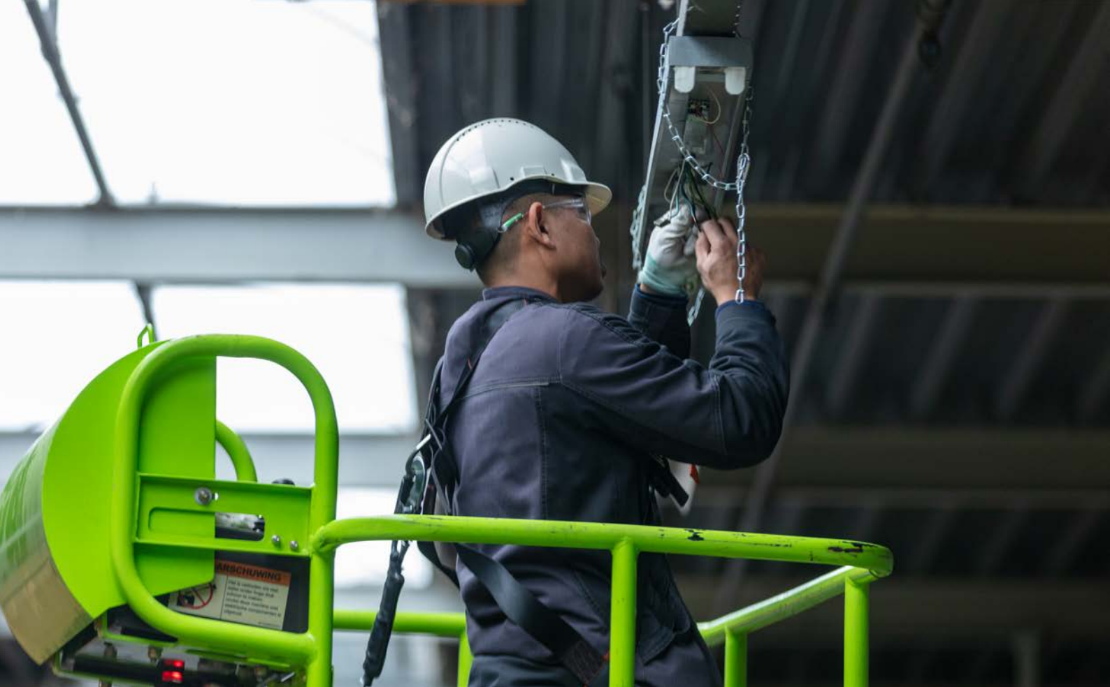
Abbildung 1: Insgesamt verbauten die Elektriker 500 Einheiten der LED T8 »Neo« und LED T5 »Neo« in die bereits vorhandenen Leuchten.
