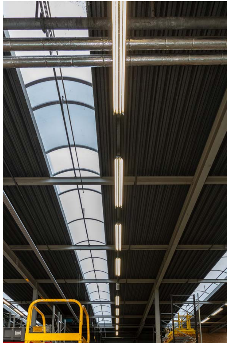
Abbildung 2: Die Beleuchtungsanlage gewährleistet die Dimmbarkeit sowie die Einbindung in Notbeleuchtungssysteme.
